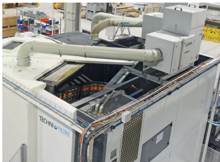
► Christian Strippoli de Technifiltre a conçu le dispositif de double aspiration Icarus-Losma sur les machines de très grande dimension
