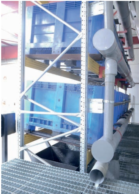
➤ Récupération des égouttures
