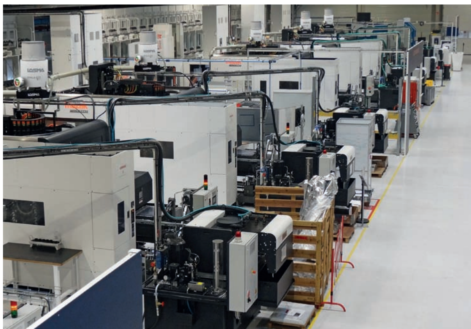
» Installation en Ligne de filtration
