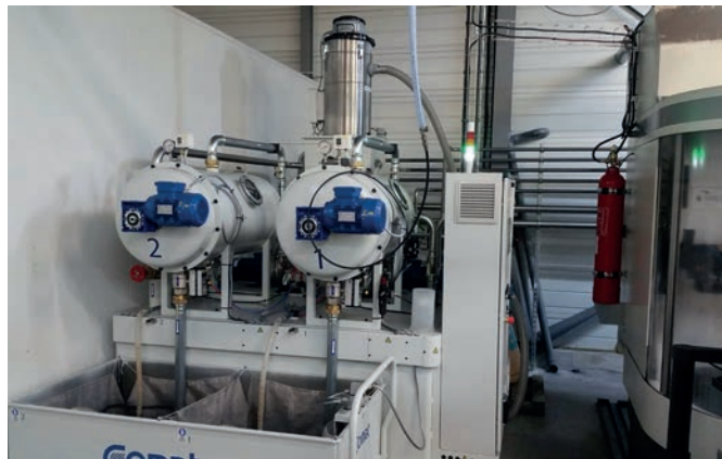
► Outre le choix de lubrifiant haut de gamme MKU, l'entreprise a installé une centrale de filtration Comat
