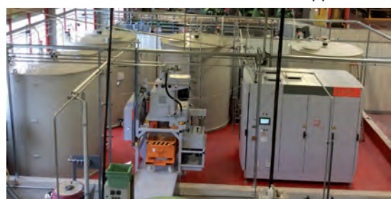
» Installation de filtration et d'évaporation d'eau de tribofinition et de de process de ressuage
