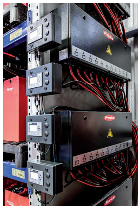
» Chaque Box est équipée de plusieurs sorties qui permettent d'alimenter jusqu'à dix batteries l'une après l'autre
